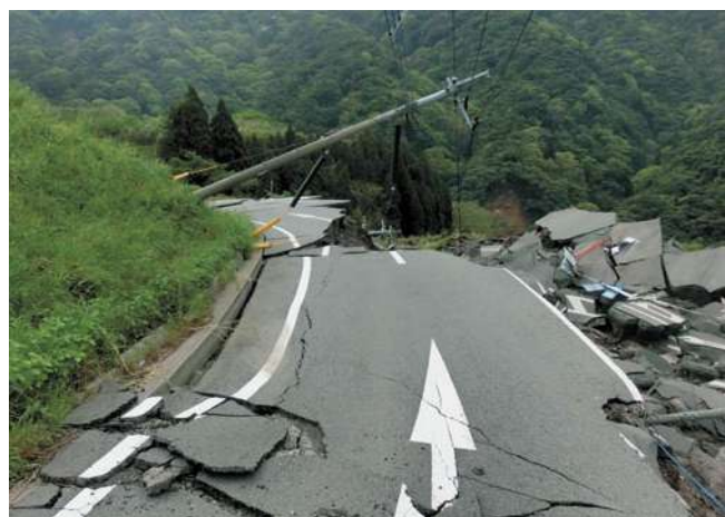
道路の崩落は阿蘇地域を孤立させた
